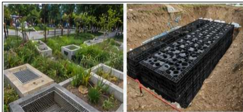
EPM Medellín – Parque Norte: piloto SUDS con módulos de almacenamiento e infiltración gradual para alivio del Interceptor Oriental.
